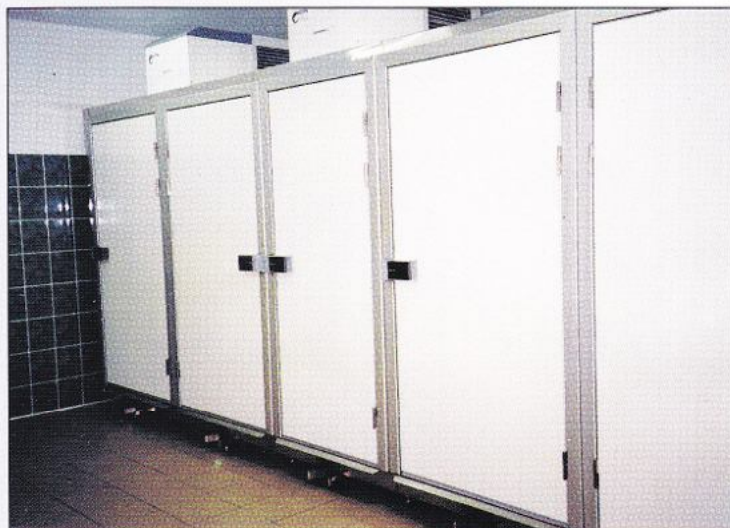
Zblokowany zestaw trzech komór na 4 ciała na tacach i 9 w trumnach (Stargard Szczeciński).
